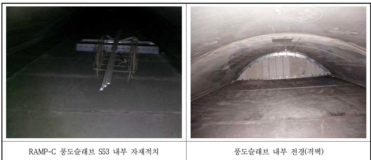
【사진 3.3.28】 NATM구간 풍도슬래브 손상현황
