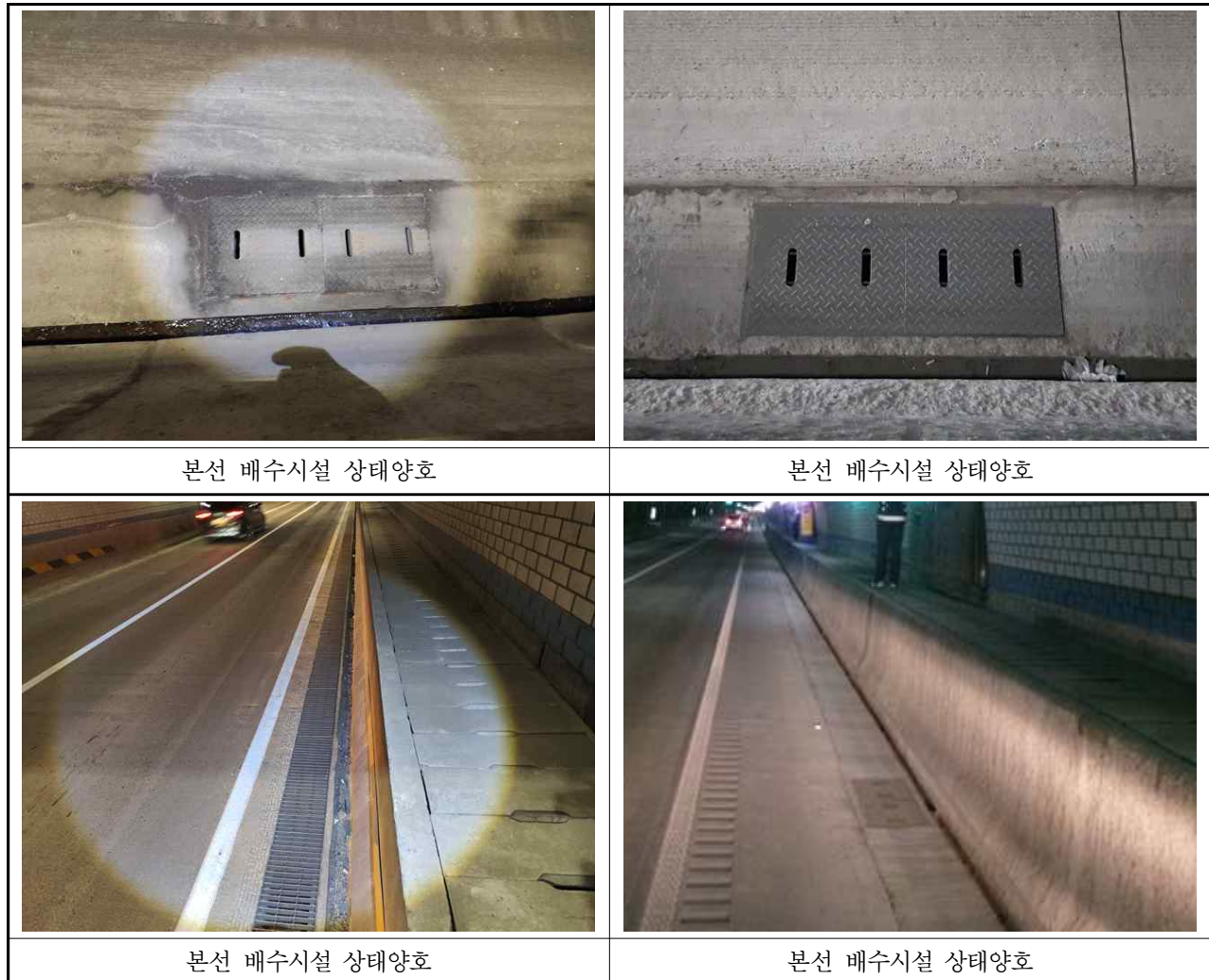
【사진 3.3.16】 배수시설 손상현황
