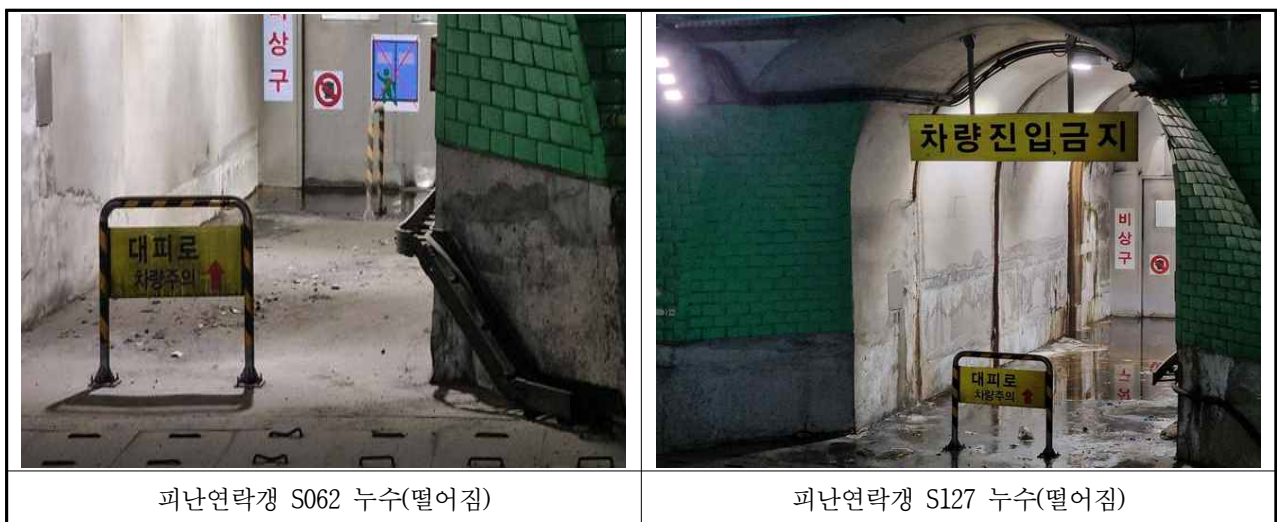
【사진 3.3.38】 피난연락갱 손상현황
