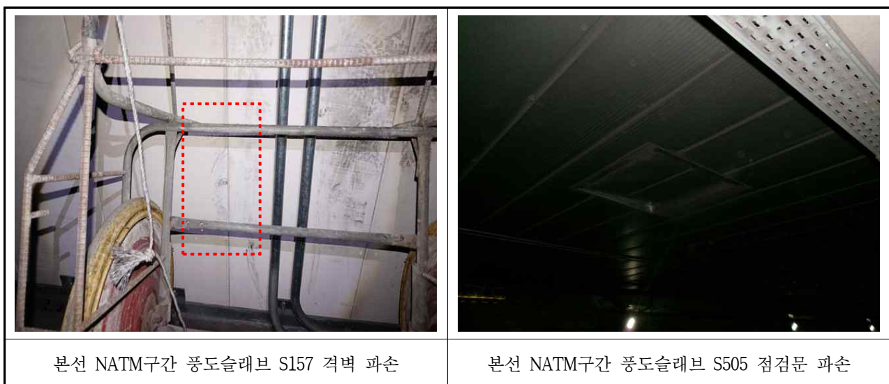
【사진 3.3.10】 NATM구간 풍도슬래브 손상현황
