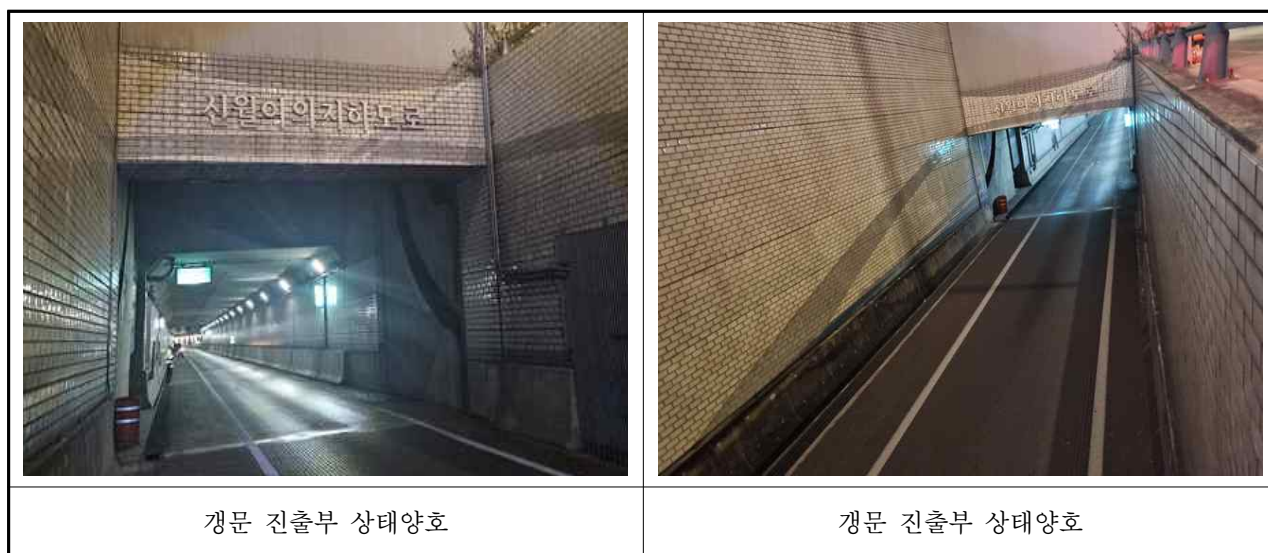
【사진 3.3.36】갯문 손상현황
