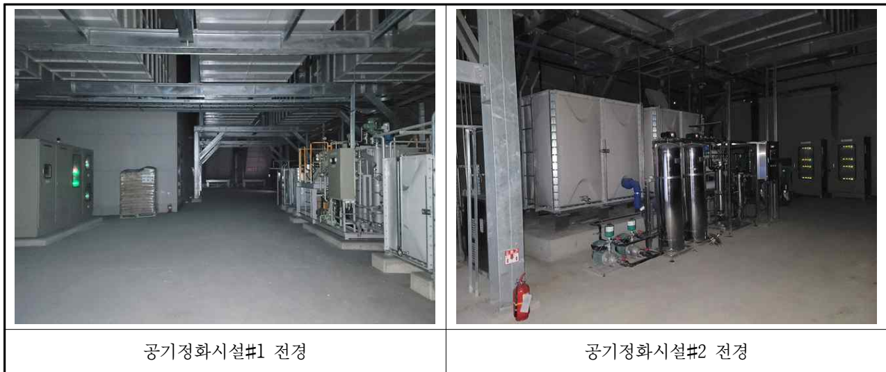
【사진 3.3.39】 공기정화시설 전경
